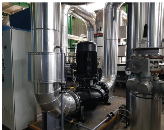
2. kép. Észak-budai Fűtőmű új visszakeverő szivattyú
