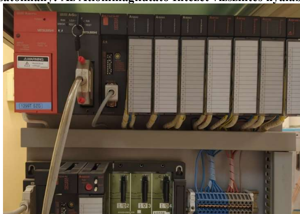
8. csatolmány: A már felújított elektronikus vezérlés
